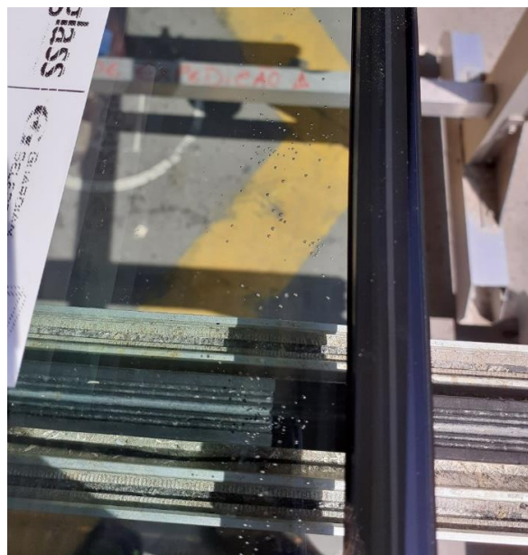
Figura 45 - Não conformidade vidro - resíduos pontuais na zona E
