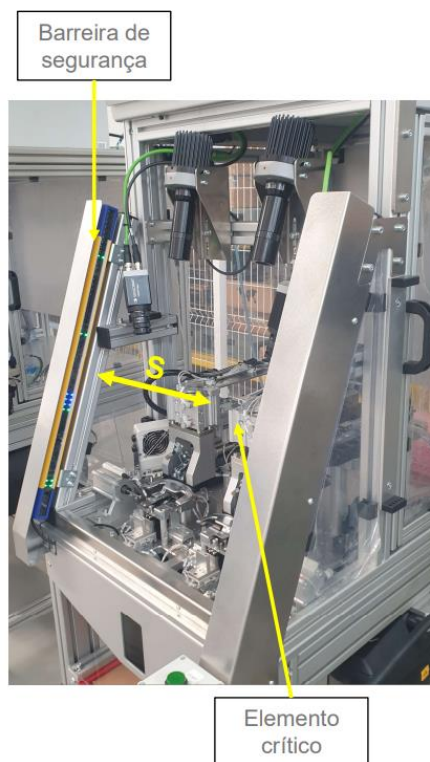
Figura 40 - Barreiras de segurança aplicadas num equipamento.
