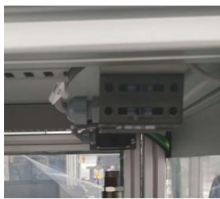
Figura 36 – Interruptor de segurança nas portas de manutenção.
