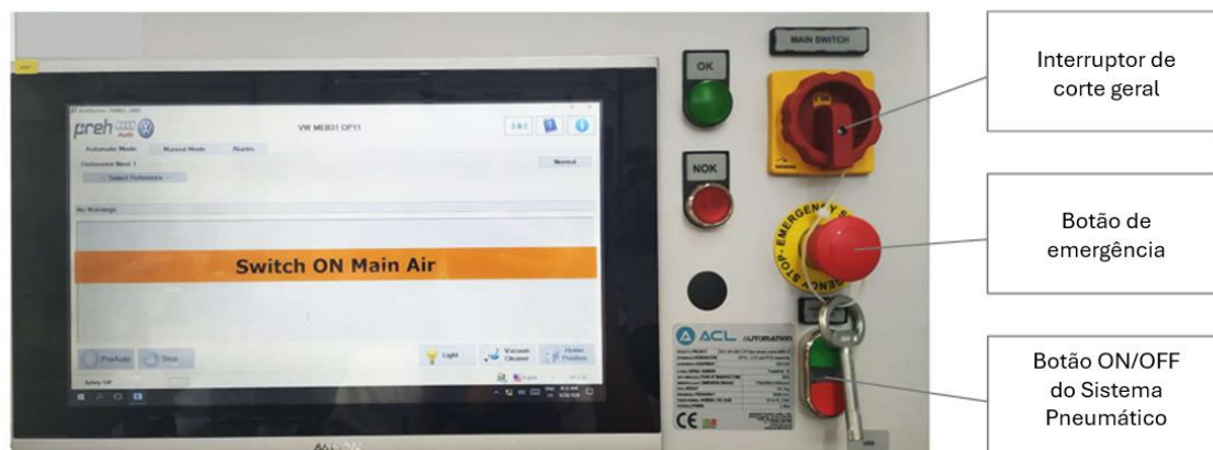
Figura 35 - Elementos relativos à segurança geral do equipamento.
