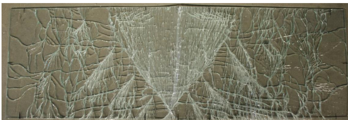
Figura 85 – Padrão de fendilhação após rotura do provete P3.
