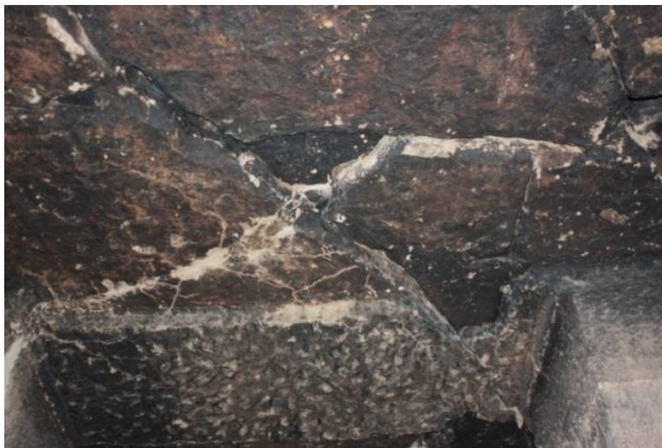
Figura 96. Pormenor das fracturas e fuligem no teto do túmulo.
