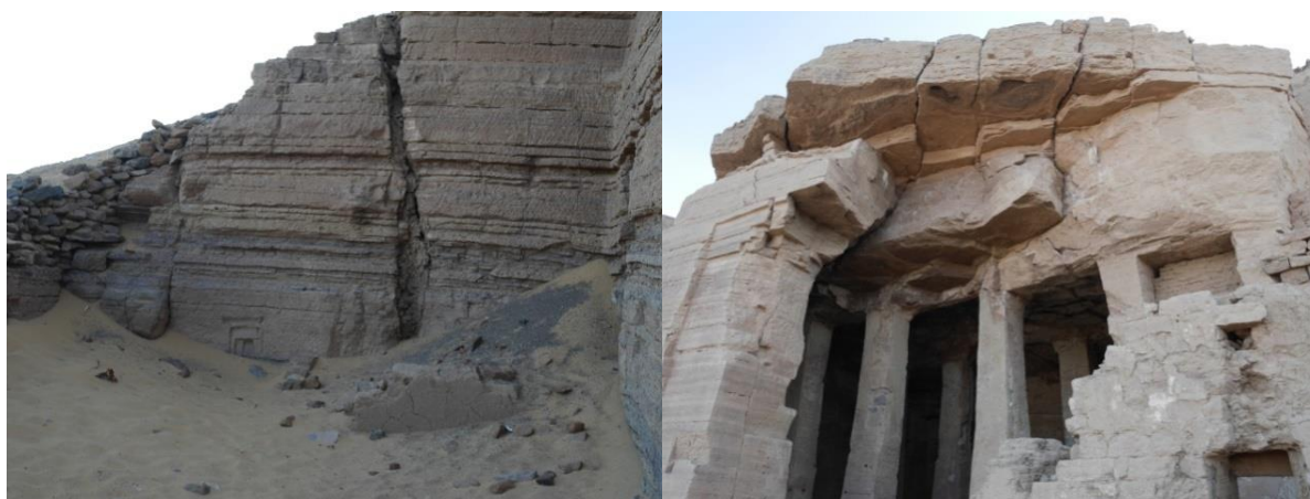
Figura 88 e 89. Exemplos de diversos tipos de fendas e da erosão da rocha
