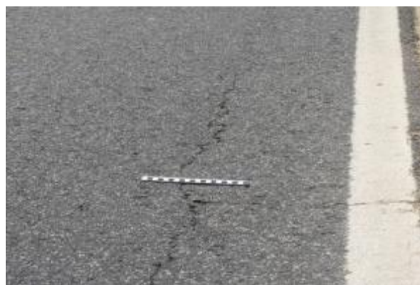
Fenda longitudinal - nível 2 (IP)
