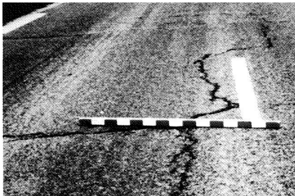
Fenda longitudinal - nível 3 (LCPC)
