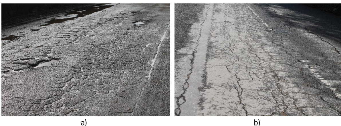
Figura 46 – Degradação superficial do pavimento: a) ninhos e peladas associadas a um elevado nível de fendilhamento do tipo “pele de corcodilo”; b) fendilhamento generalizado do pavimento
