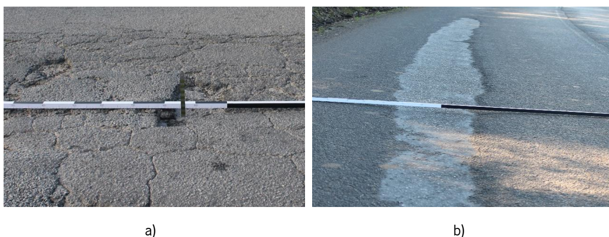
Figura 29 – Defeitos de superfície: a) ninhos e peladas - nível 3; b) desagregação superficial - nível 3
