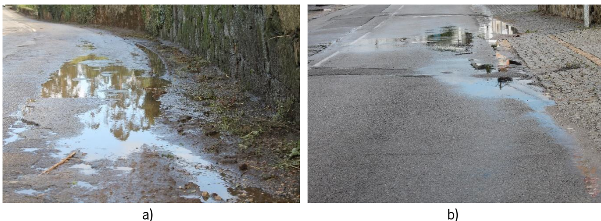
Figura 47 – Acumulação de água na superfície do pavimento por falta de conservação corrente
