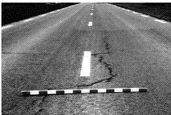
Fenda longitudinal - nível 2 (LCPC)
