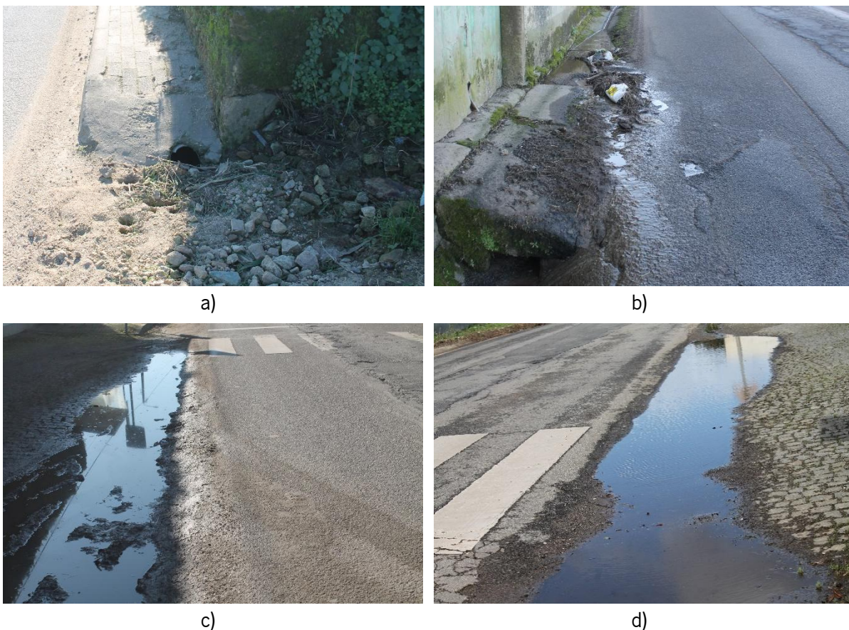
Figura 48 – Anomalias na drenagem de águas pluviais
