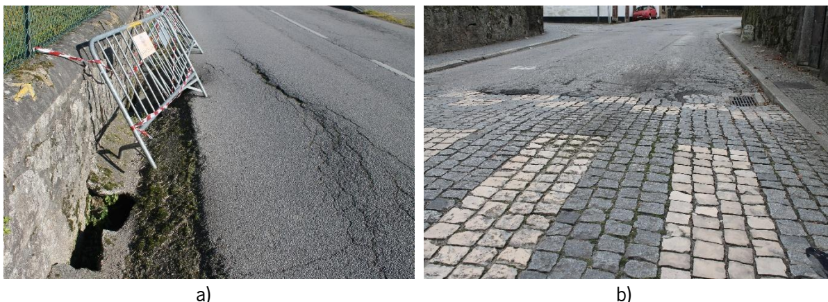
Figura 45 – Degradações superficiais do pavimento provocadas por: a) problemas de drenagem; falta de conservação
