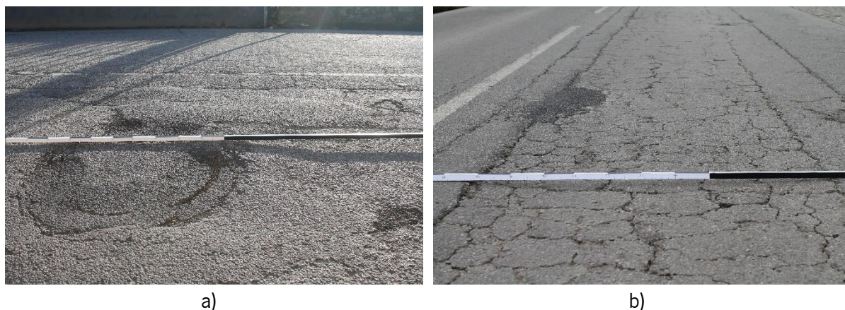
Figura 28 – Deformações: a) deformações localizadas - nível 3; b) rodeiras - nível 3
