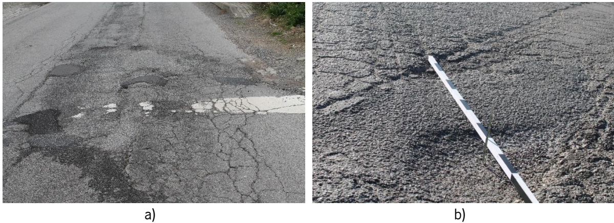
Figura 30 – Reparações: a) tapagem de covas - nível 3; b) remendos - nível 3
