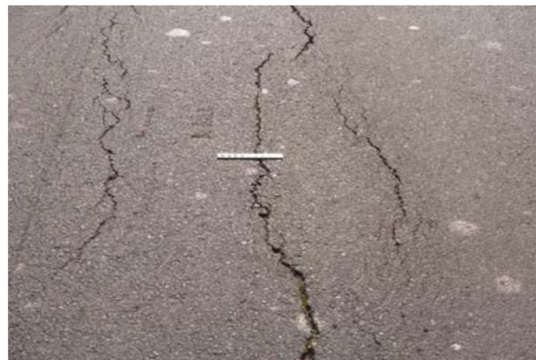
Fenda longitudinal - nível 3 (IP)
