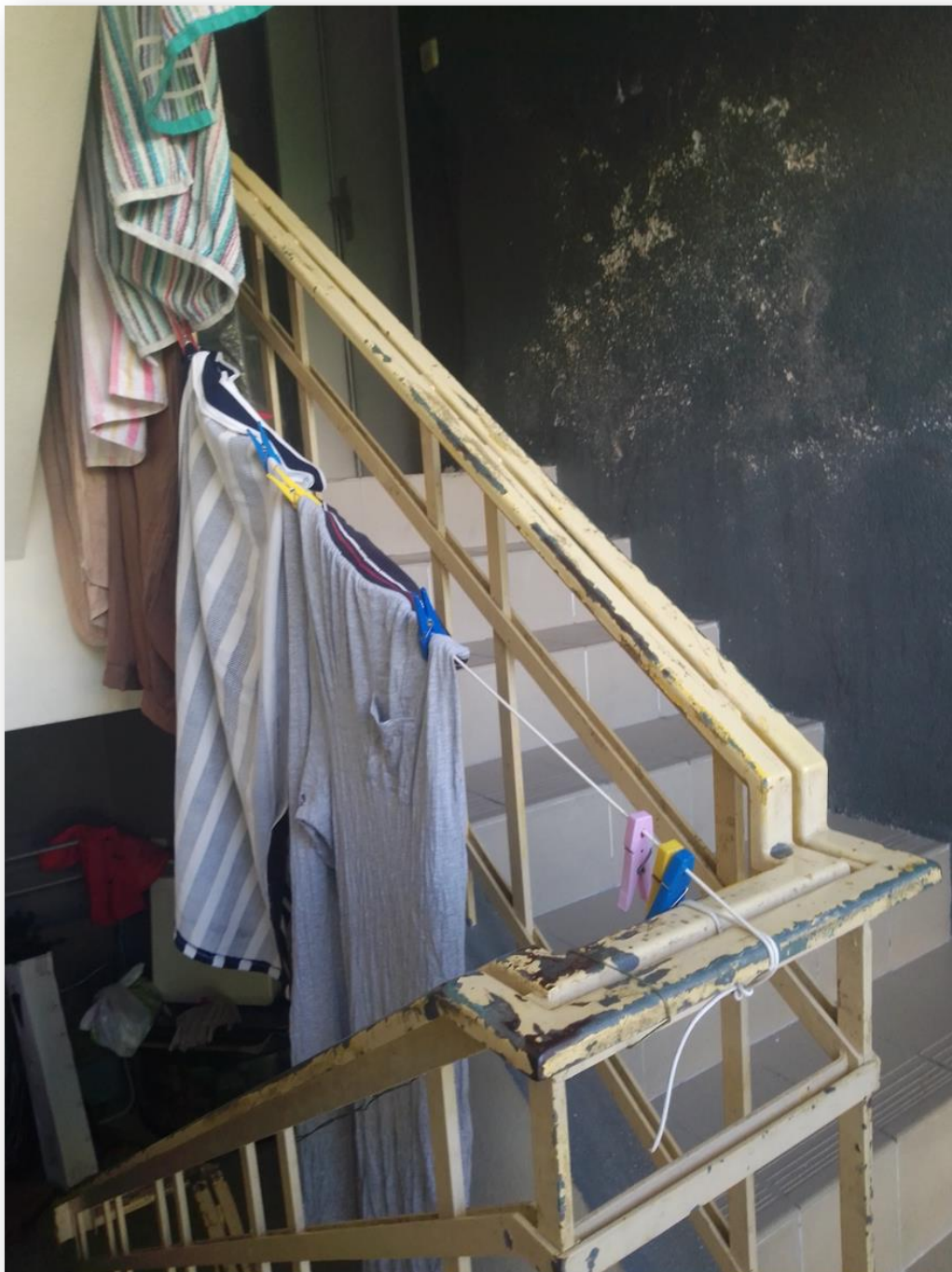
Fotografia 14 - Condições das partes comuns
