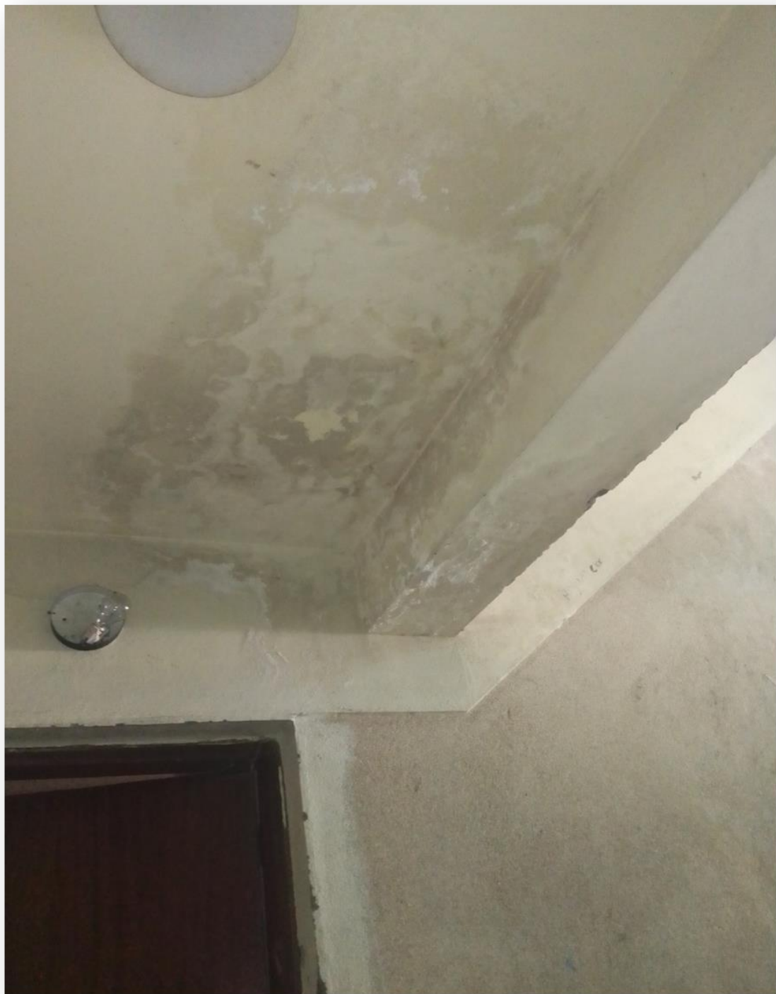
Fotografia 17 - Parede com manchas de humidade
