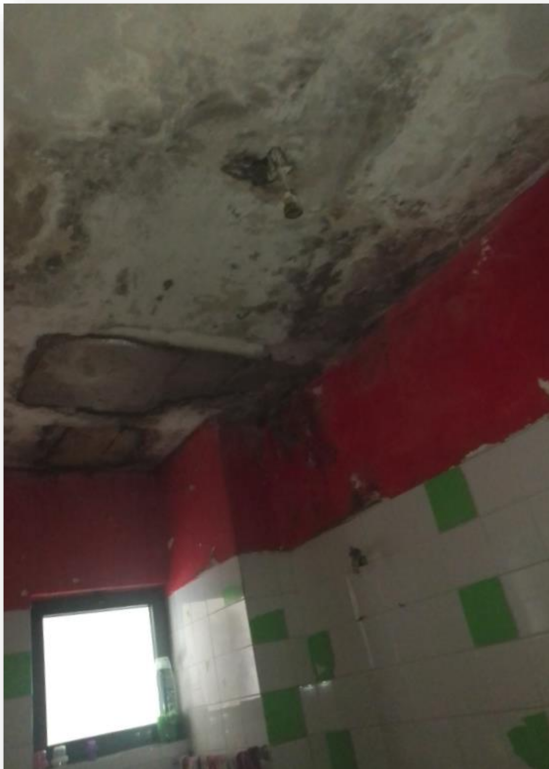
Fotografia 18 - Teto com humidade sem lâmpada
