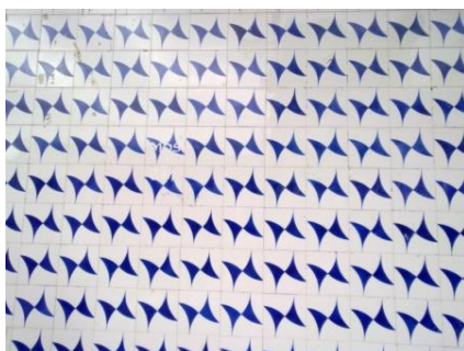
Fig. 18 Painel azulejado de características modernistas, atualmente em estado de degradação. Fonte: Acervo pessoal dos autores, 2011.
