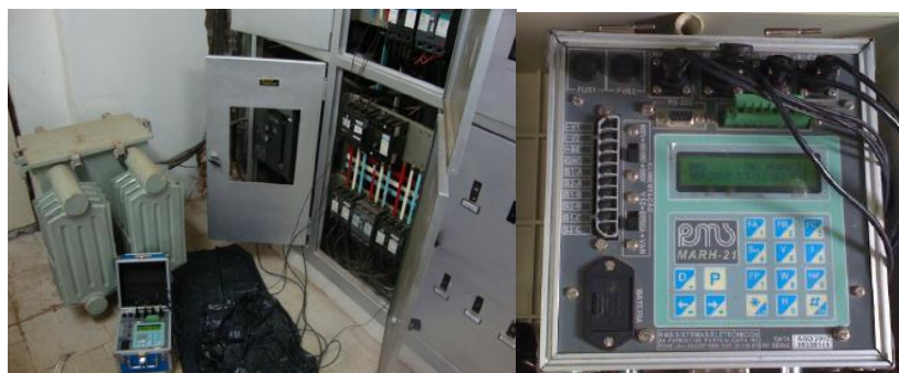
Fig. 5 – Medição de um barramento do sistema elétrico do Hemocentro de Brasília
