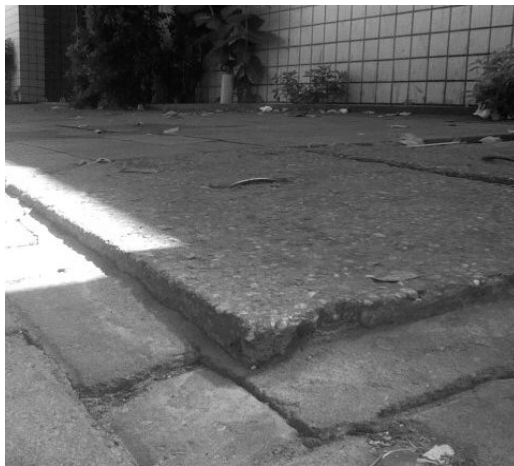
Fig. 03 Tampa de concessionária no meio da calçada. Fonte: Nestor Castro (2011)
