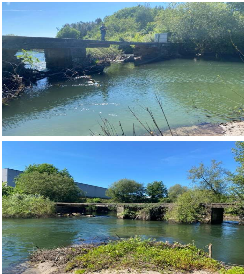
Figura 45 - P4: Alto risco de colapso. Fonte: Autor.
