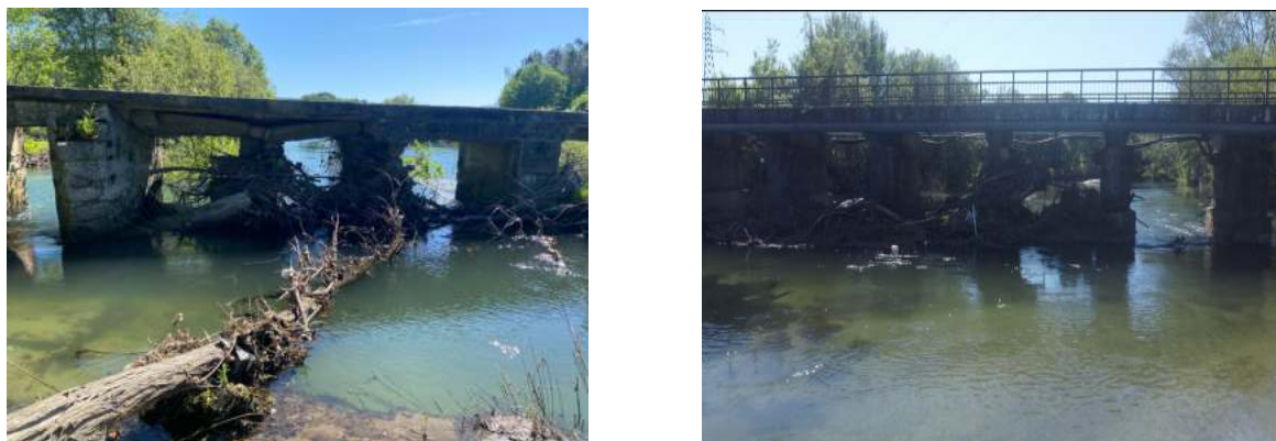
Figura 39 - P5 e P11: Congestionamento de detritos. Fonte: Autor.
