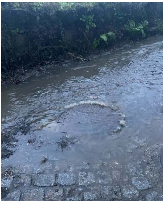
Figura 25 - Sistema de drenagem junto ao Laboratório da Paisagem. Fonte: Autor.
