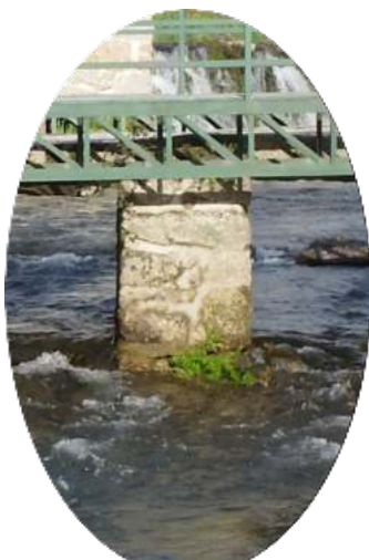
Figura 42 - Fluxo junto do pilar da P15. Fonte: Autor.
