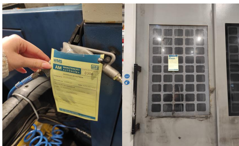
Figura 27 - Problemas na pistola de ar comprimido e no vidro do VTR
