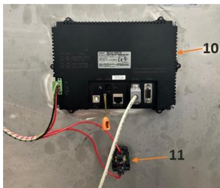
Figura 5.15 - Quadro elétrico com numeração dos componentes
