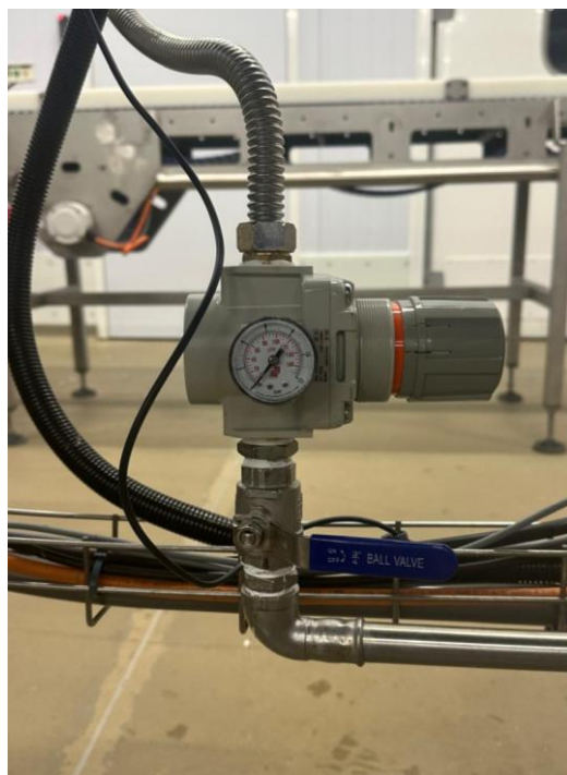
Figura 5.10 – Controlador de pressão manual instalado na rede
