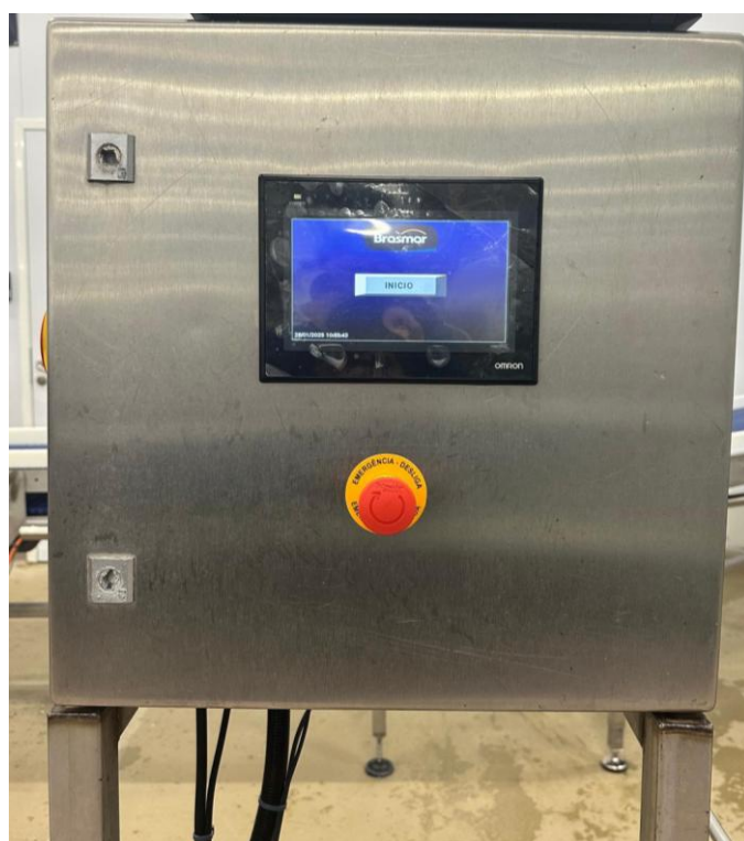
Figura 5.11 – Consola HMI e botão de emergência instalados
