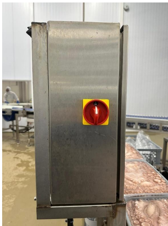
Figura 5.12 - Interruptor de corte geral do sistema instalado
