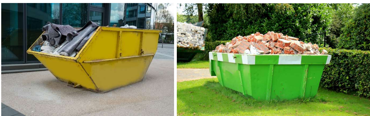
Figura 8- Acondicionamento temporário de resíduos em diferentes frações.
