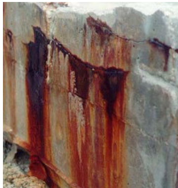
Figura 12 – Exemplo de corrosão numa estrutura de betão armado
