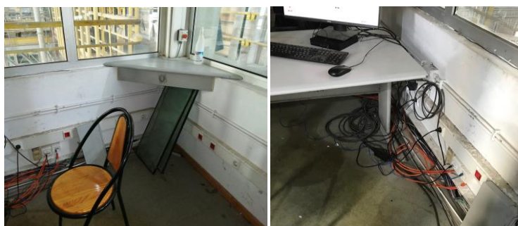
Figura 31-Situação inicial na sala de controlo do AV5
