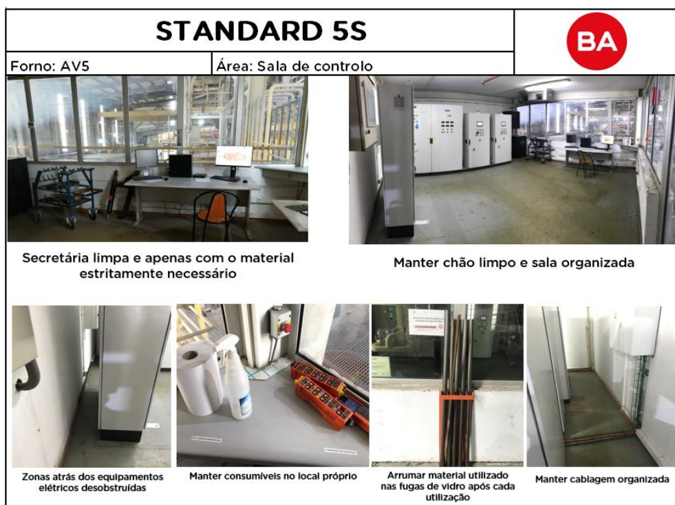
Figura 80-Standard 5S Sala de controlo do AV5
