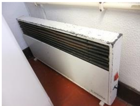
Figura 36 – Radiador elétrico de 2 kW presente numa sala de aula da escola [49].
