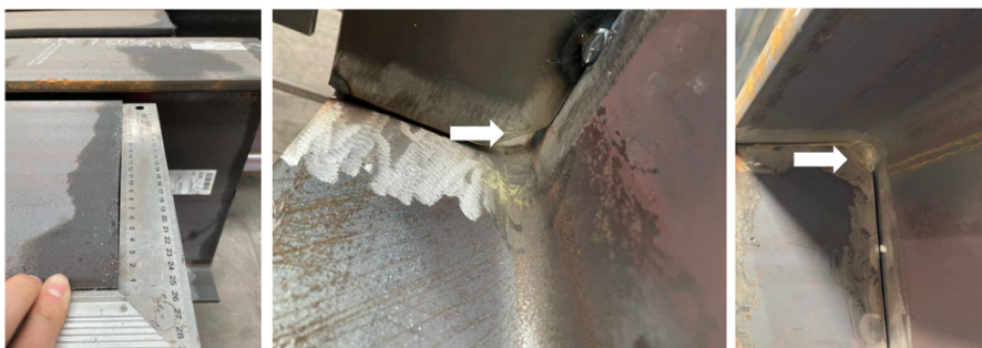
Figura 23: Defeitos na Chapa.
