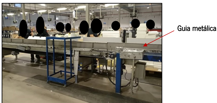
Figura 145 - Guia metálica da linha Kallfass
