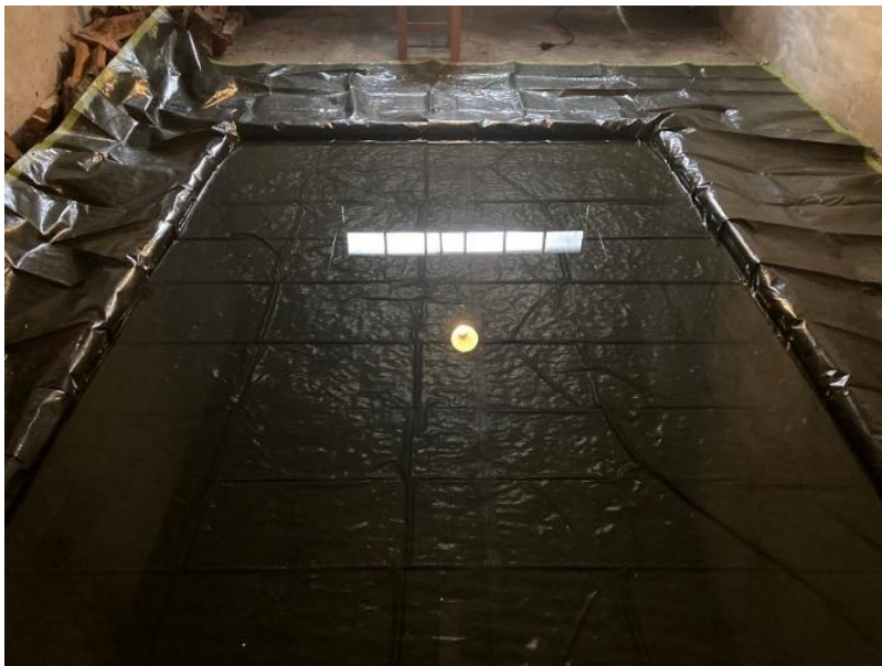
Figura 33 – Tanque com água
