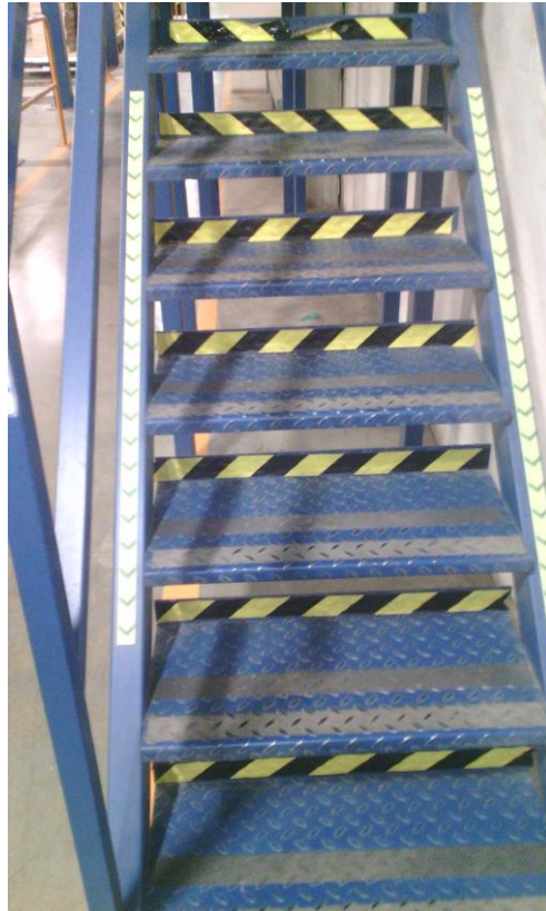
Figura 51 - Sinalização dos degraus e fita antiderrapante nos degraus.
