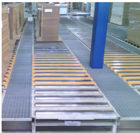
Figura 50 - Passadiços sinalizados para circulação nas linhas de rolos de cor amarela.
