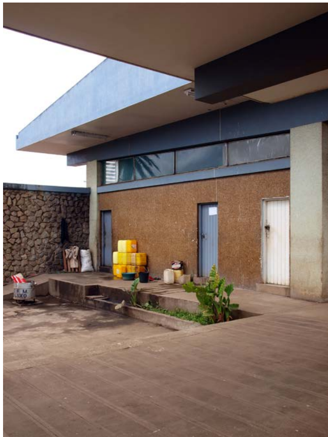
Figura 4.32 - Desnível entre a plataforma do cais e a Sala de Espera. (EM, 2010)
