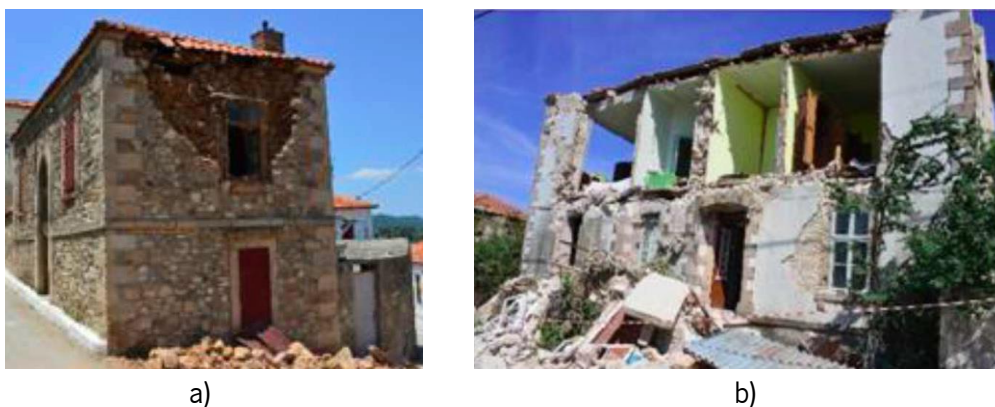
Figura 23 - Colapso de paredes para fora do plano: a) rotura da parede para fora do plano devido à falta de um diafragma rígido, b) queda das paredes longitudinais de alvenaria para fora do plano devido a fraca ligação entre às paredes transversais (Maraveas, 2019)
