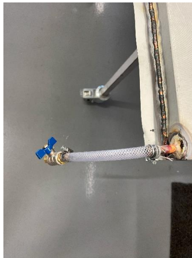
Figura 43: Válvula instalada no depósito de água.
