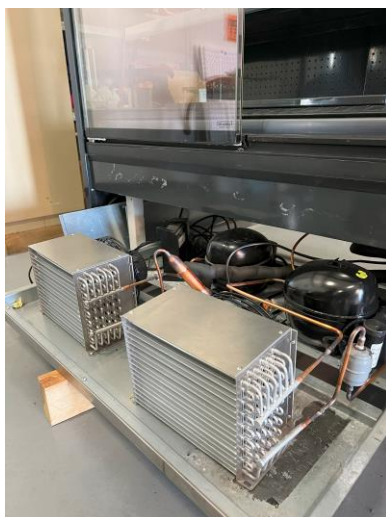
Figura 47: Unidades condensadoras dos dois ciclos de compressão de vapor.
