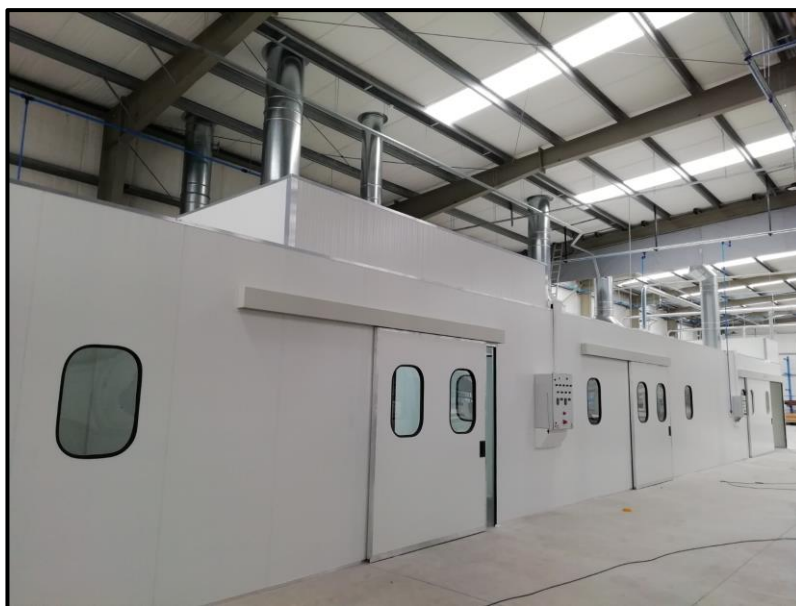
Figura 44.Exemplo de uma cabine climatizada
