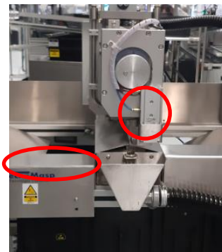
Figura 69 – Identificação das superfícies, do equipamento Singulation , mal protegidas.
