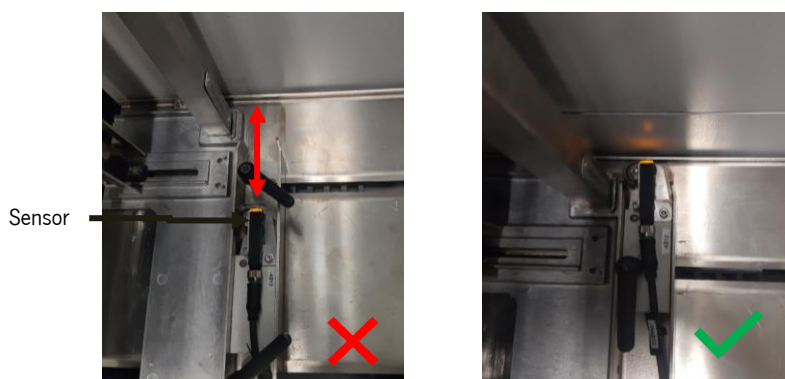
Figura 88 – Antes e depois da alteração do sensor do unloader .
